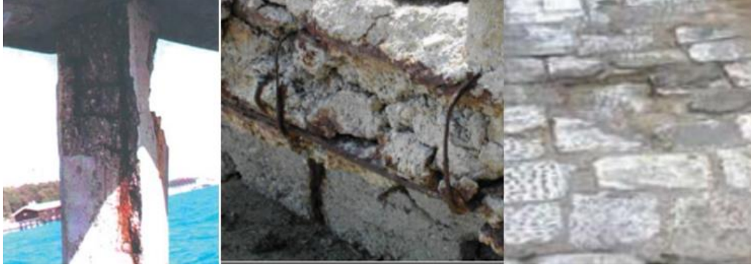
Şekil 1. Aşınma Etkisinde yapı elemanları [2]
